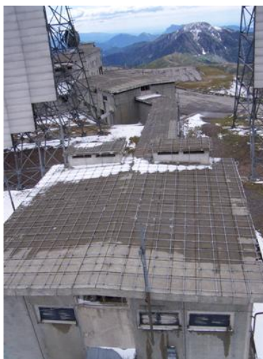
Completamente schermato anche il Blocco il Blocco Troposcatter (O.H.) Il Corridoio ed il Blocco Microwave (L.O.S.) (2006)
