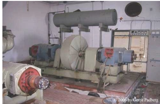
No-Break con Cisterna Carburante per il Generatore (Sopra) ed il Pannello di Controllo e Stabilizzatore No-Break e Generatori
